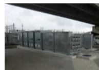
(昨年新設したポイント制御盤)
